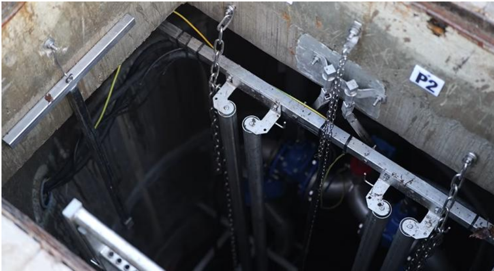
Widok z góry przepompownia ścieków P2 w Więmierzycach
