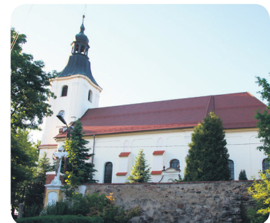
Remont dachu na kościele w Lipnikach gm. Kamiennik przeprowadzony w ramach działania Odnowa i rozwój wsi.
